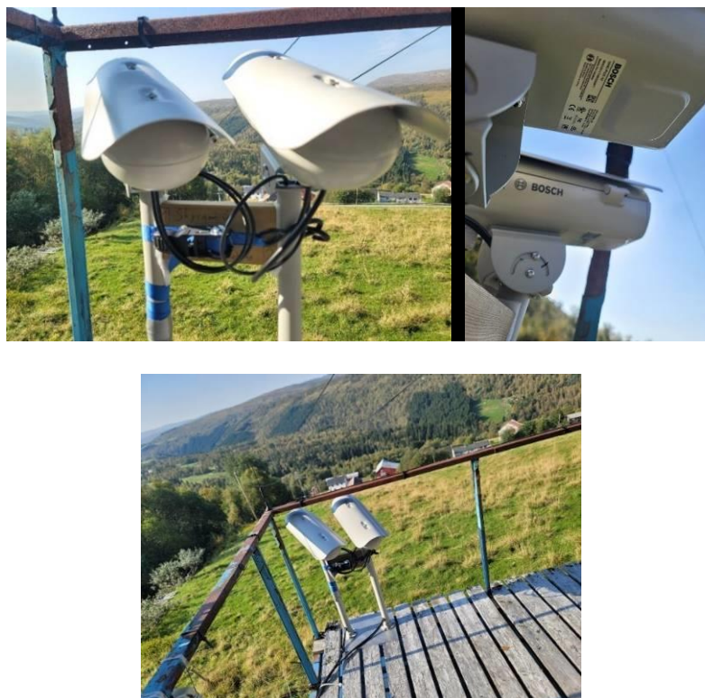
Рис.3. Камери спостереження Bosh UHO-POE-10 на станції «Блакитна»
