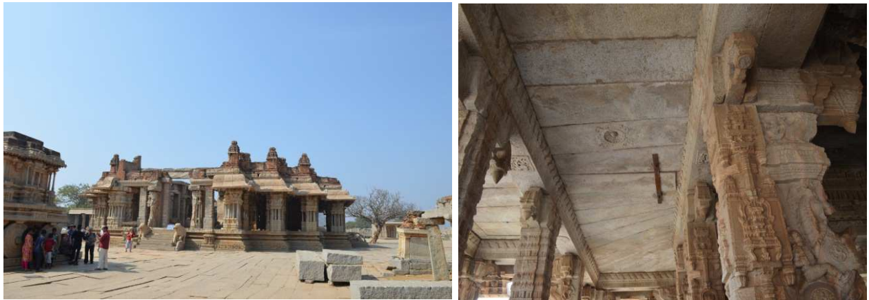
Рис. 5.4.4. Одна із споруд храму із «музичними» колонами, зліва видно колісницю і справа - новітню будову із гранітних блоків; підсилення плити покриття храму металевою пластиною
