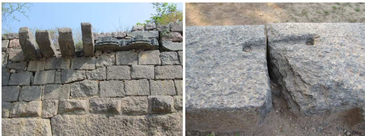
Рис. 5.2.6. Деградація технологій обробки каменю з плином часу на прикладі улаштування середньовічного мурування; імовірно пізніші скріплення елементів металевими скобами
