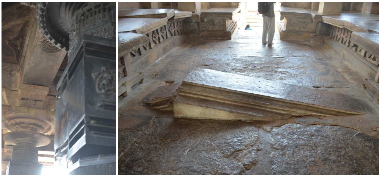
Рис. 5.3.5. «Вм'ятина» навмисно виконана на колоні будівельниками; рештки падлих, а пізніше зацементованих ригелів а також посувки плит всередині храму внаслідок землетрусу біля 400 років тому
